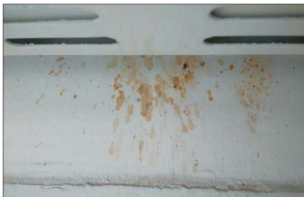
耿女士家因暖气片漏水污染了墙面。
