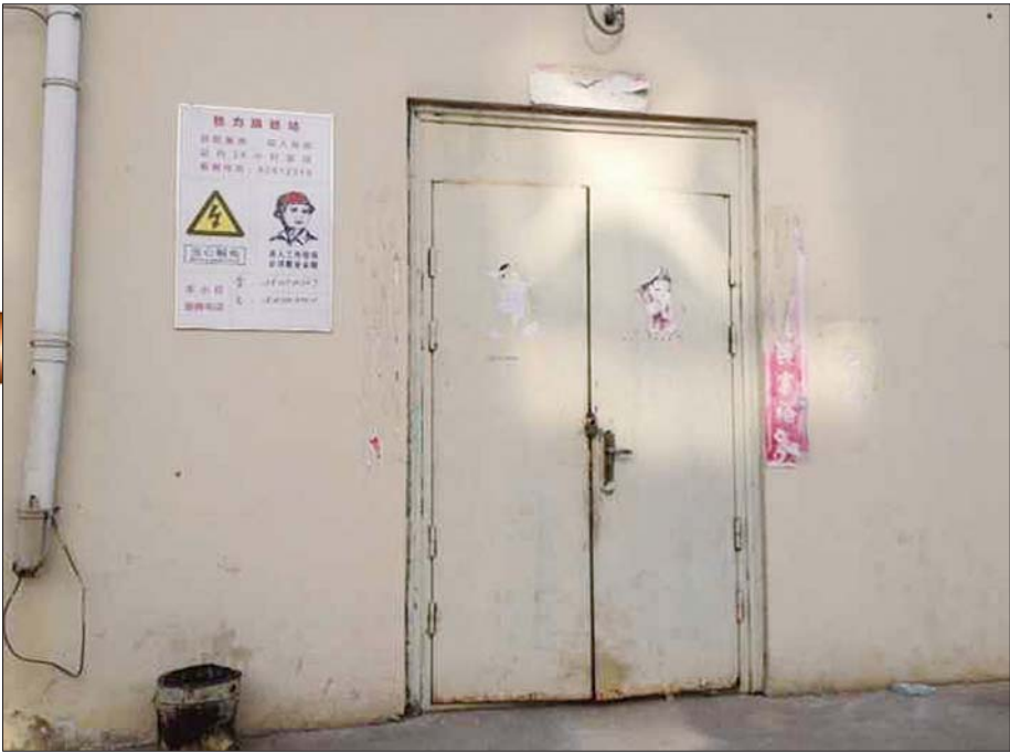
位于奥体片区的一家换热站,在黄泰热力全面回收的过程中产生纠纷,目前还没有打压。
