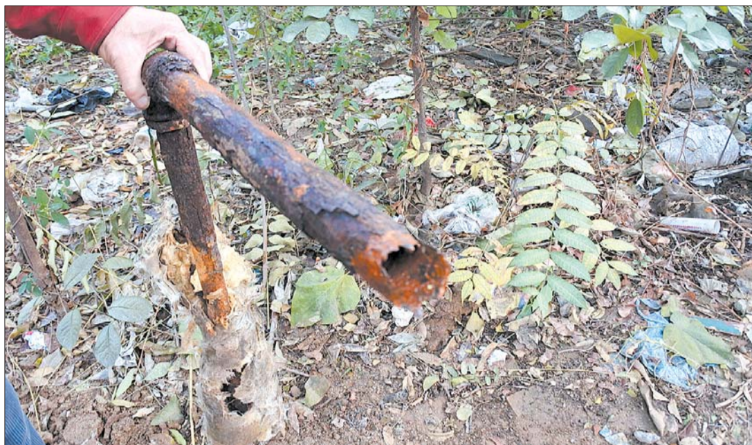
小区内供暖管网年久失修,腐蚀严重。本报记者 蒋龙龙 摄
