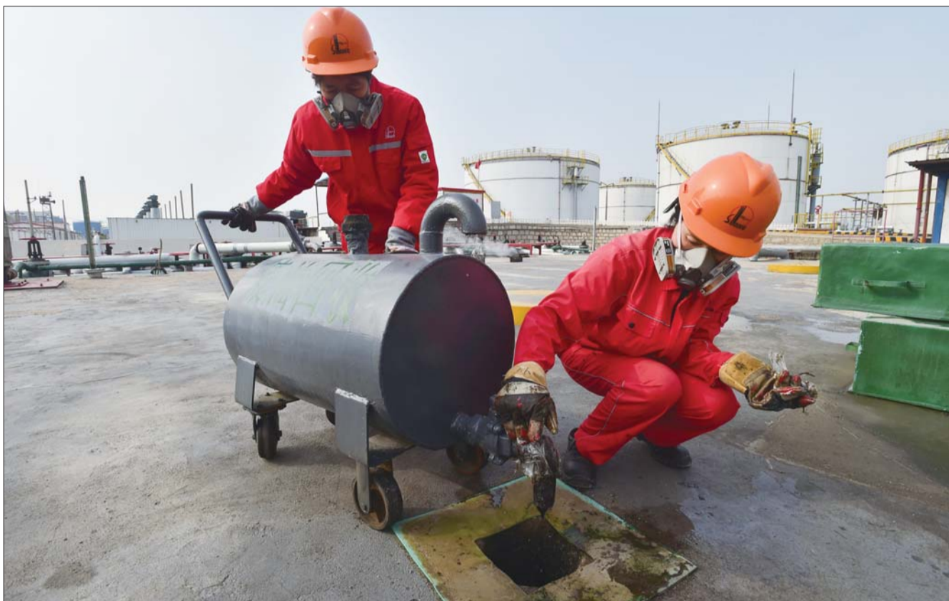
集输站女工自制回收装置对站内废油进行清理,从而保持现场整洁。
