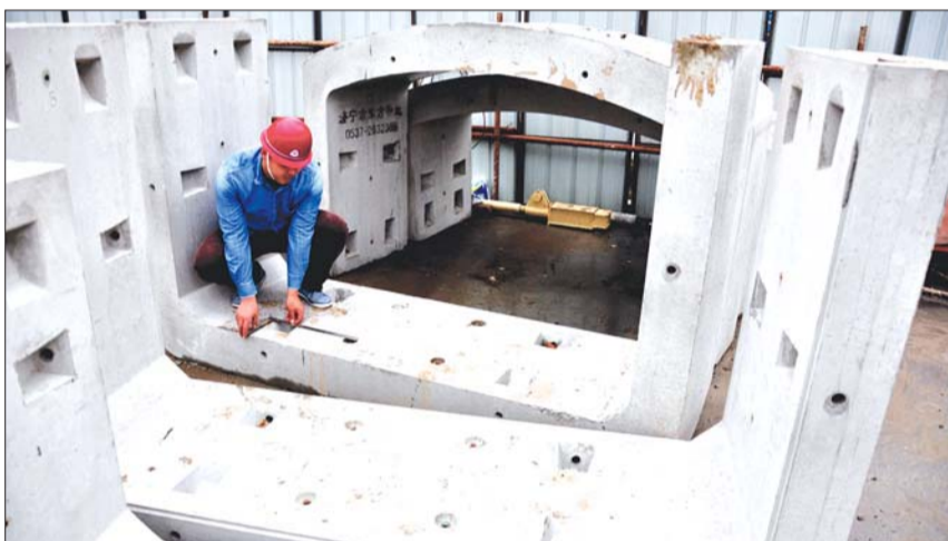
两拼矩形盾构工艺所使用的管壁
