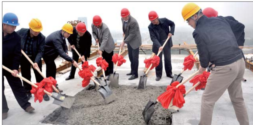
济宁市中医院新院区综合楼病房楼完成最后一斗混凝土浇筑。通讯员 王碧辉摄
