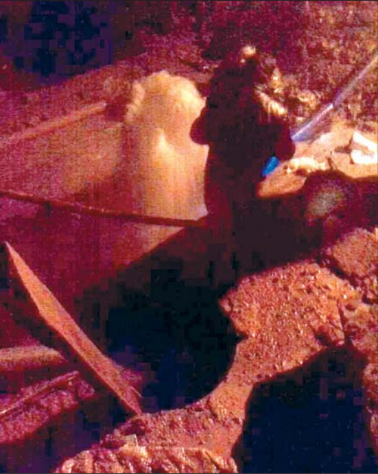
供暖主线路遭破坏,供暖水如喷泉。
