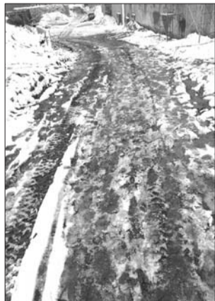
福景佳苑项目一期工程工地内沟壑遍布、泥泞不堪的施工道路。本报见习记者 张永宽 摄
