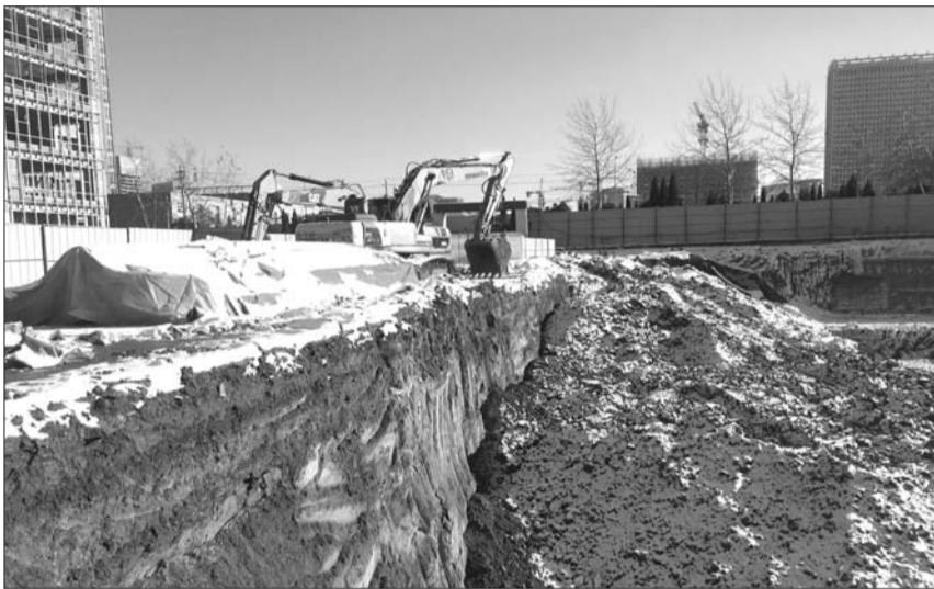
联合财富广场项目,基坑内大量渣土并未覆盖,直接裸露在外。本报见习记者 张阿凤 摄
