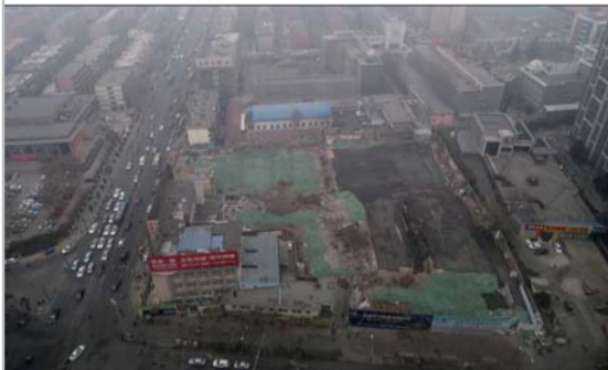
22日,历山路路边一建筑工地上,防尘网没能将建筑垃圾全面遮盖。专家介绍,建筑垃圾扬尘也是造成雾霾的主要原因之一。 本报记者 左庆 摄
