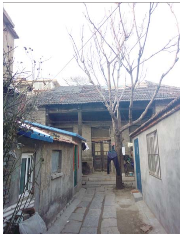
鞠思敏故居的房顶漏水,用塑料布覆盖。
