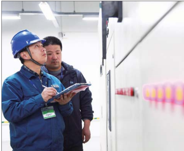
贾化宁与辖区企业经理一起检查配电室设施，提出节能改进意见。
