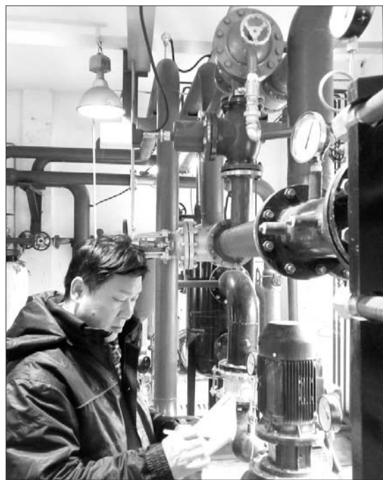
济南供热工作人员正在检查管网运行情况。 本报记者 蒋龙龙 摄
