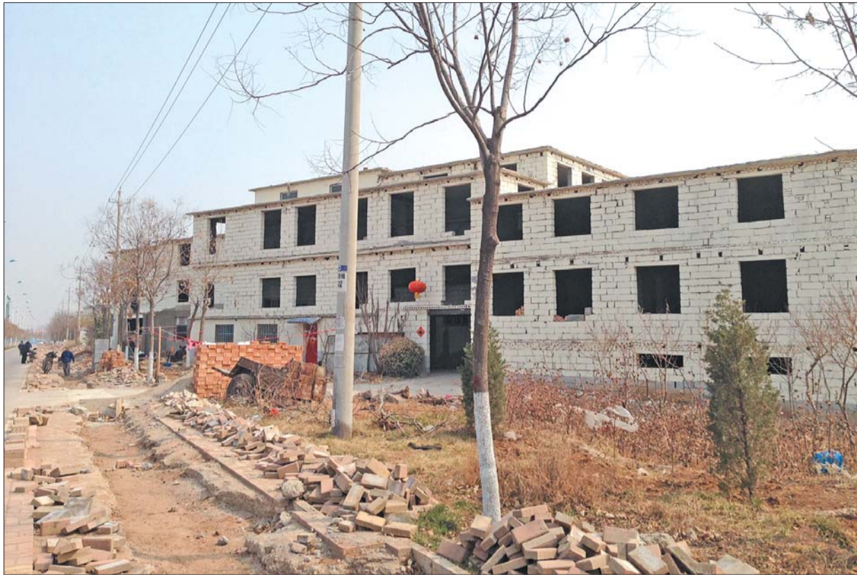
像这样无门窗、无水电的加盖房在百突泉村随处可见。
