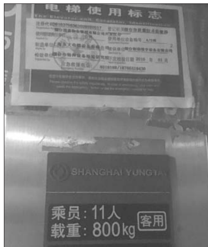
电梯内的使用标志上显示,电梯已超期未检。
