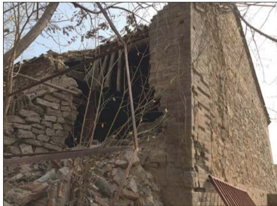
青云观的大殿(廊庙)还保存着,但大殿的后墙已经塌了一大块,成了一座“危庙”。
