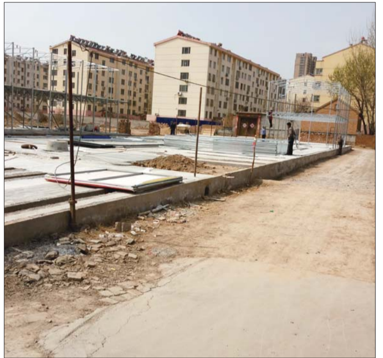
村集体土地上咋有人悄悄建房 相关部门：属于违法施工建设，已立案调查
