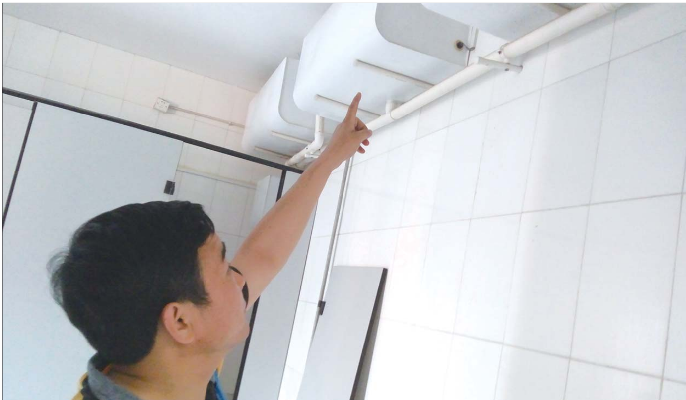
山东政法学院宿舍卫生间内的节水设施可储存上一层楼的洗漱用水,用来冲厕所。 本报记者 蒋龙龙 摄
