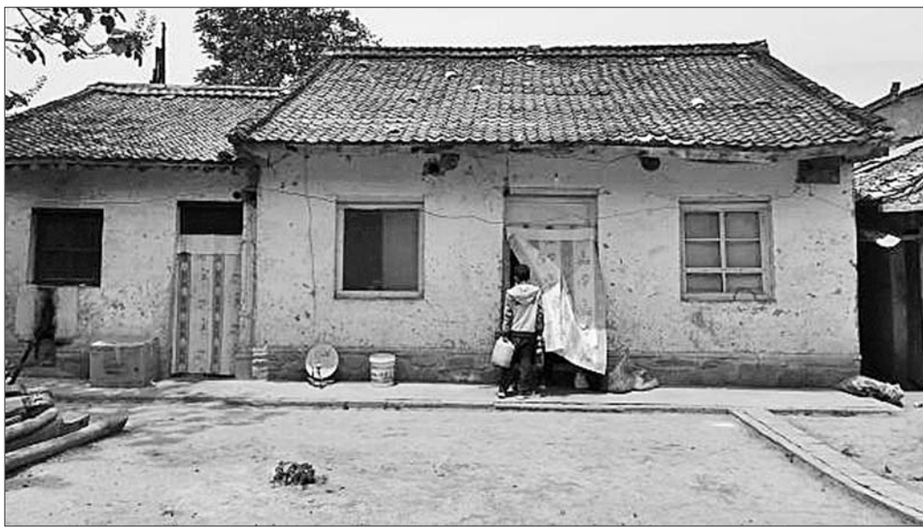
范银贵一家三口租住的危房。 据澎湃新闻
