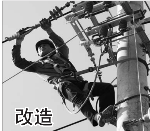
5月18日,武城县供电公司10千伏盐厂线进行了绝缘化线路改造,提升电网安全运行可靠性。 本报通讯员 郑智慧 摄
