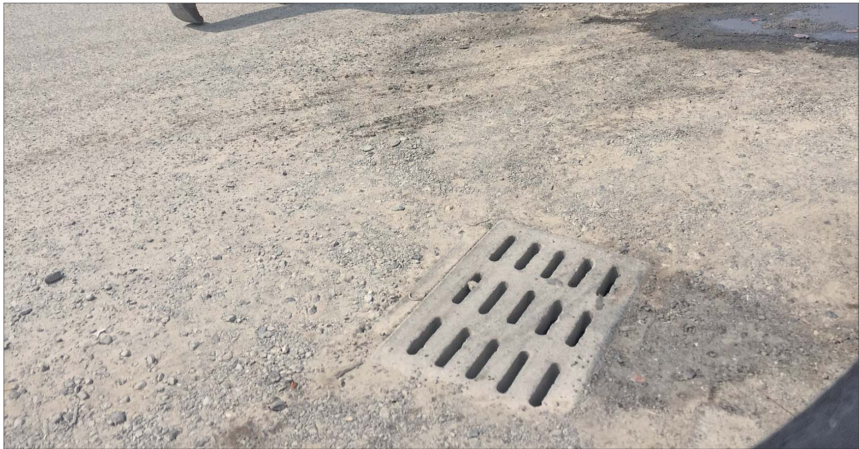
银河路地势低洼,路面不平,下水口排水不畅。
