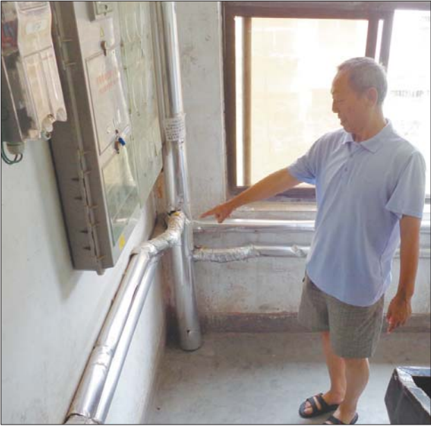
2号楼内去年刚换了供暖管道。 本报记者 孟燕 摄
