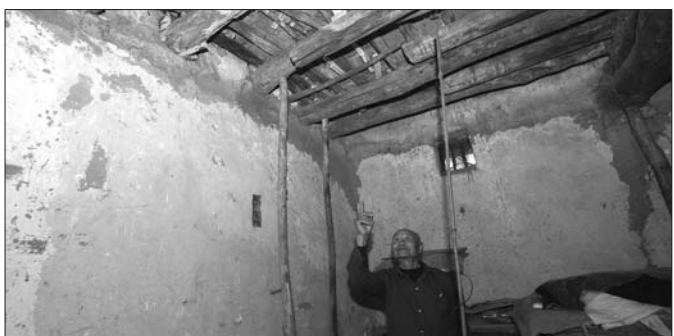
王庄村许多房屋破损严重,有的不得不用木杆顶着防止塌落。 本报记者 张中 实习生 郭松健 摄
