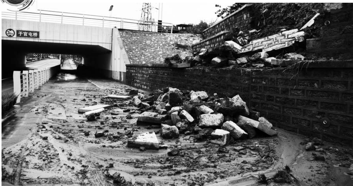
岔河西大道于官屯大桥涵洞附近,受雨水冲刷刷护坡发生坍塌。
