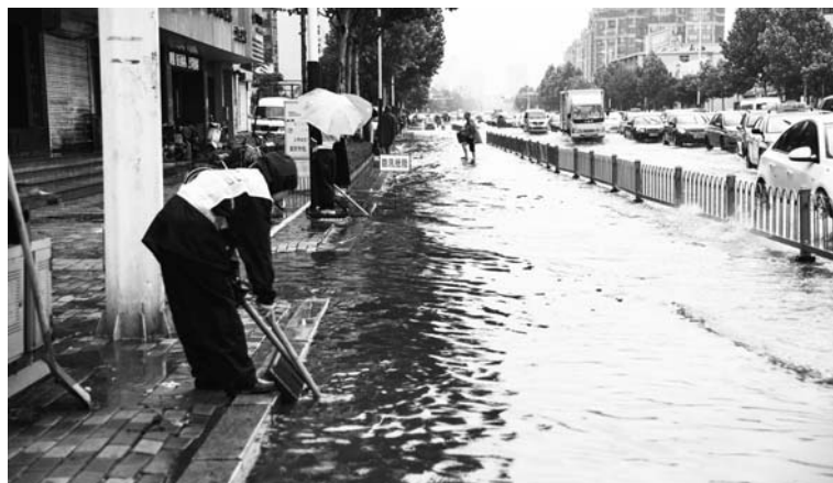
天衢路东来顺路段出现积水,市政工作人员打开排水孔加速排水。
