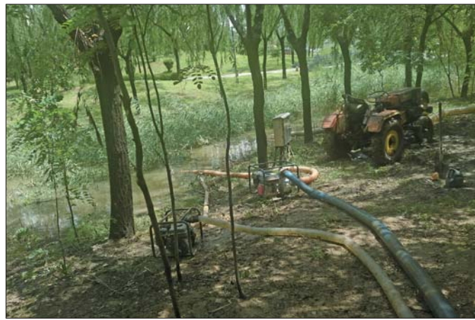
工作人员正在济北公园进行排水。 照片均为本报记者 梁越 摄
