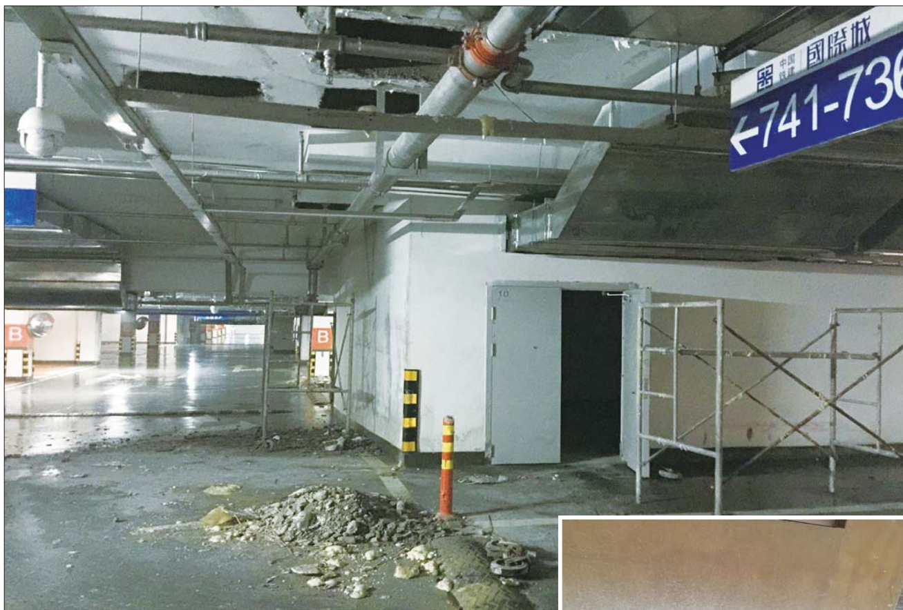
▲中国铁建国际城地下车库漏水严重，现场一片狼藉。
