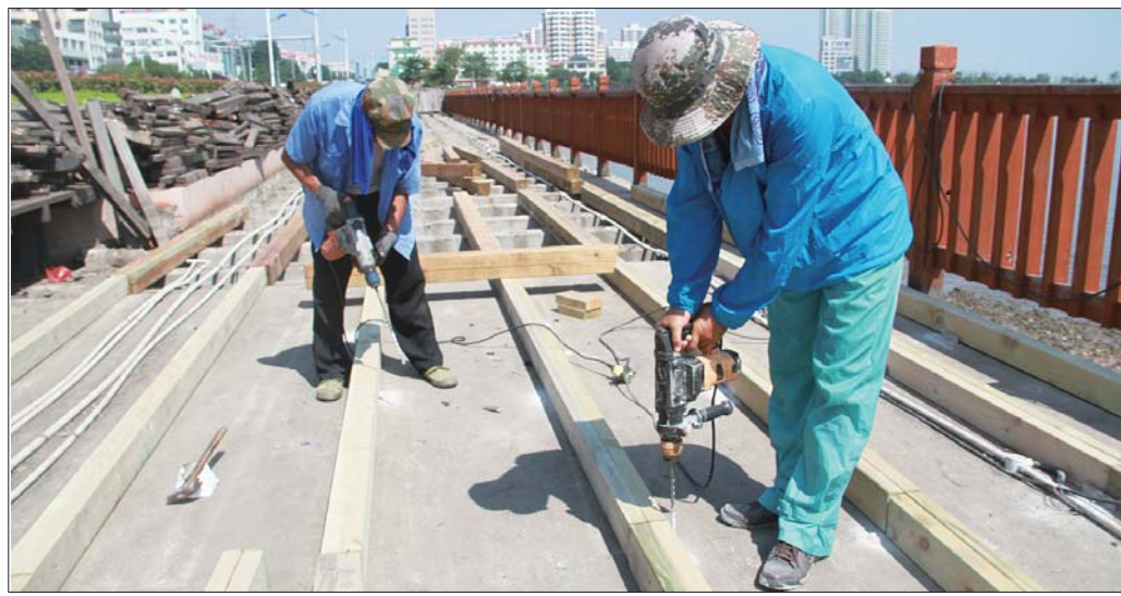
石岛滨海公园的木栈道是石岛城区的标志性建筑之一,是看海赏景的好去处。因风吹日晒,滨海公园木栈道破损严重,存在安全隐患。为确保游人安全,自7月下旬起,石岛管理区环卫处组织工人对公园南北栈桥整体维修更换。此次木栈道整修需更换面积为2800平方米,预计10月底将全部完工。张天伟 宋丰凯 摄影报道
