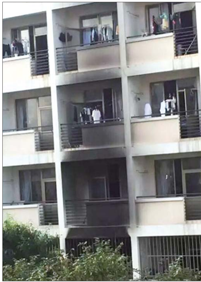
公寓楼一楼起火,殃及楼上。 本报记者 李楠楠 摄
