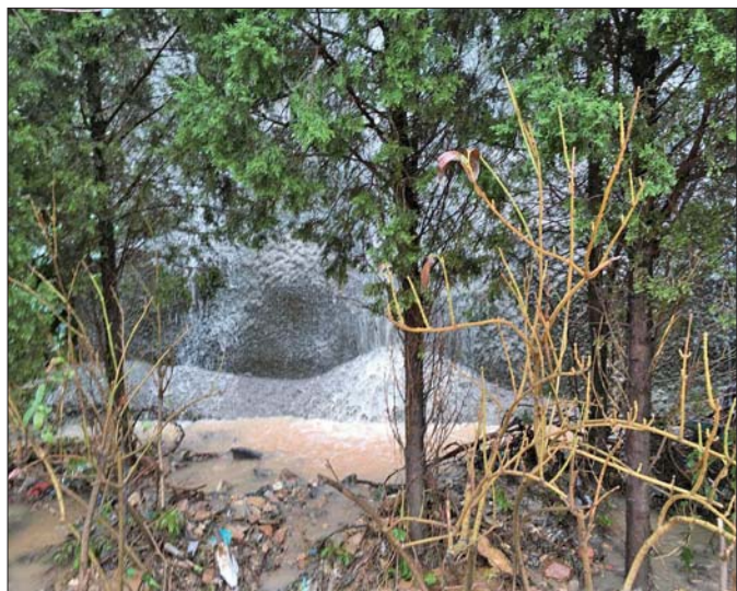
16日,旅游路南的回龙山上,雨水顺着山体支护墙形成“瀑布”冲向地面和绿化带,而附近30米处就是居民楼。
