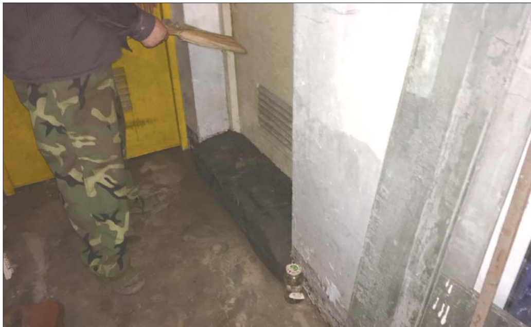
22日上午，小区2号楼地下室的积水基本排完，高过半米的积水水渍仍在。 本报记者 王皇 摄
