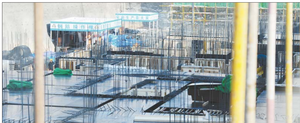
济南市有很多建筑工地正在施工。(资料片)本报记者 周青先 摄
