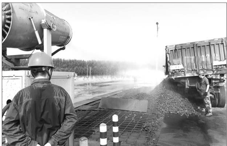
港口的堆场安装了喷雾机抑尘。
