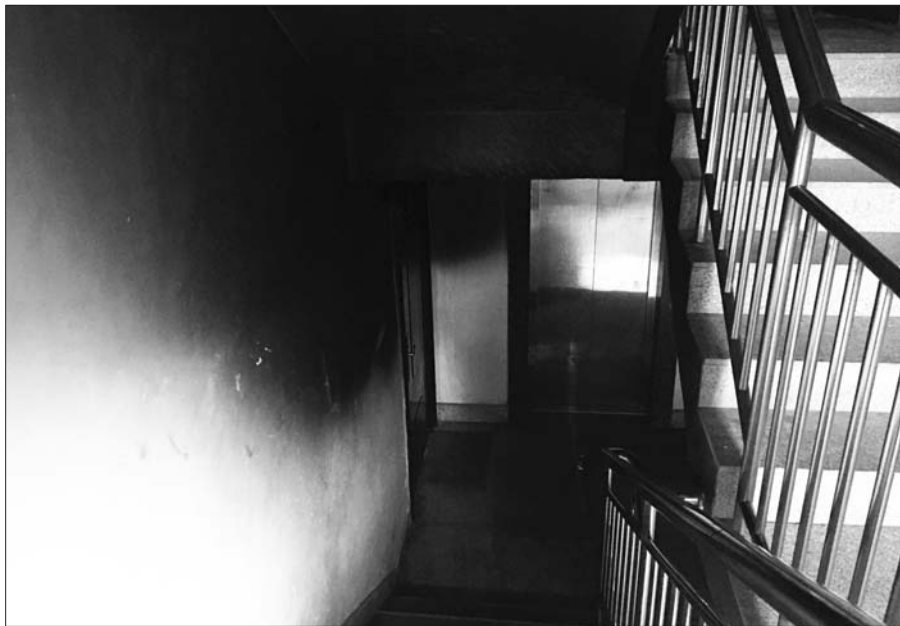
小区楼道内已被熏黑。
