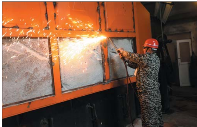
今年供暖企业拆除小锅炉,煤炭价格上涨都将导致供暖成本的上升。本报记者 蒋龙龙 摄
