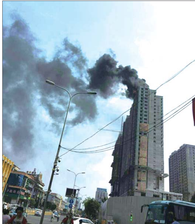
楼顶施工引燃防水材料,浓烟滚滚。 齐鲁壹点壹粉供图
