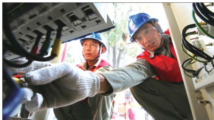
供电员工正在对备用电源自动投切柜进行接线。
