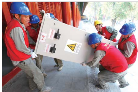
供电员工将备用电源自动投切柜搬运至大成殿两侧,为祭孔大典提供电力保障。
