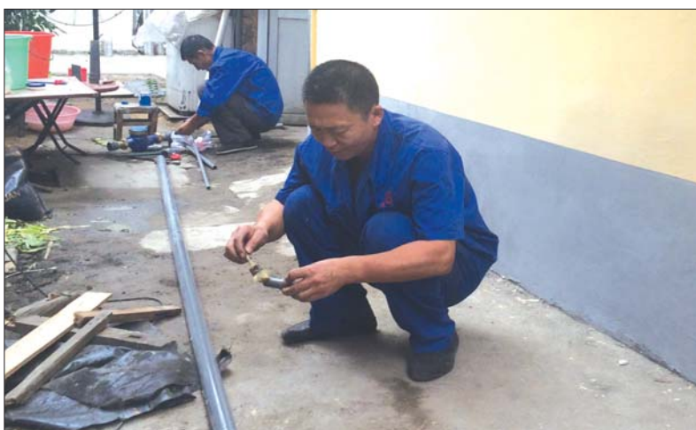
26日下午,在德工机械宿舍,工作人员在为新建的换热站启用做着准备工作。
