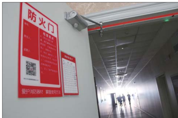
医院内,随处可见的消防标志。
