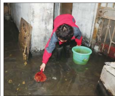
12户地下室因水管破裂成“水窖”
