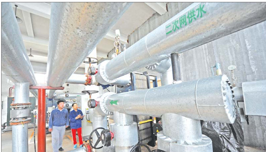
东郊热电厂的工作人员检查设备的运行情况。
