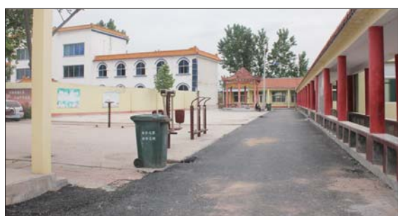
敬老院改造提升
