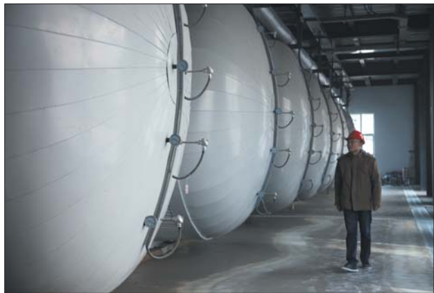
东部一小区用电锅炉供暖。 本报记者 蒋龙龙 摄
