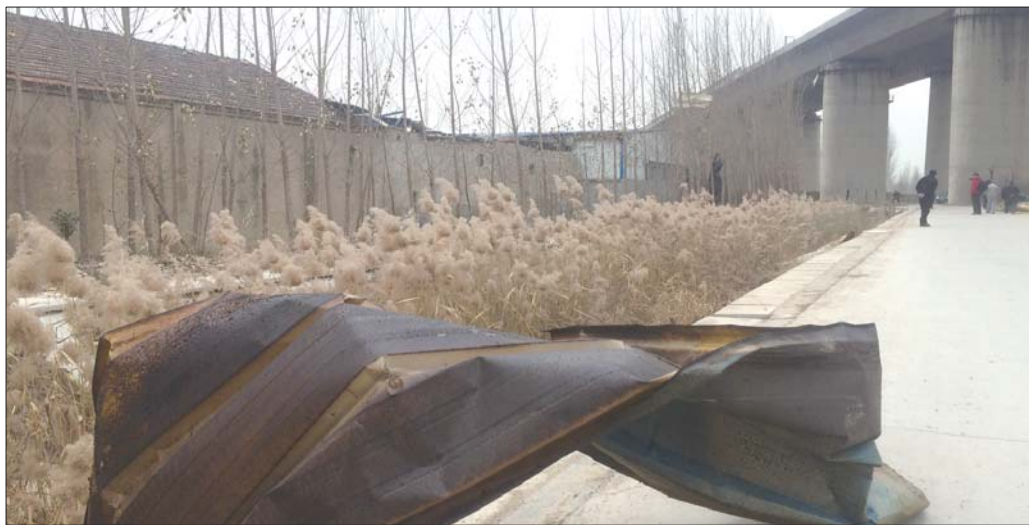
高铁桥上的隔音板掉落下来。 本报记者 许建立 摄
