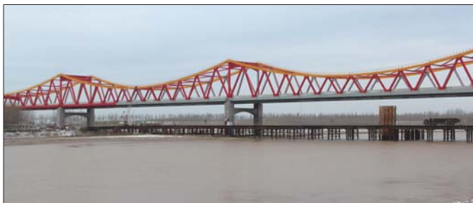
建设中的长清黄河公路大桥,预计2017年通车。通讯员 王新勇 孙焕顺 摄
