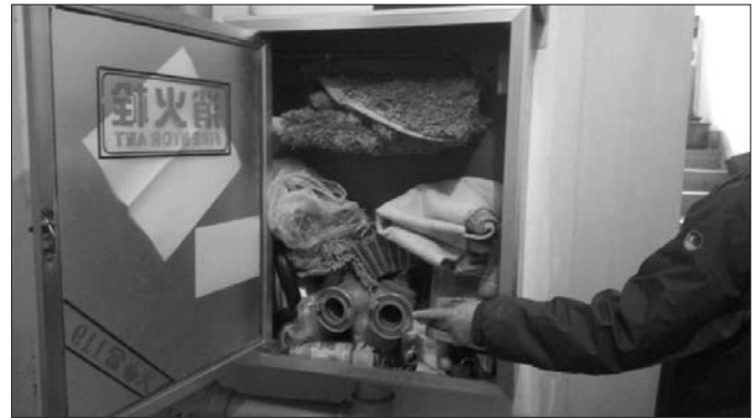
消防箱内既没有消防水带也没有灭火器。 本报记者 摄
