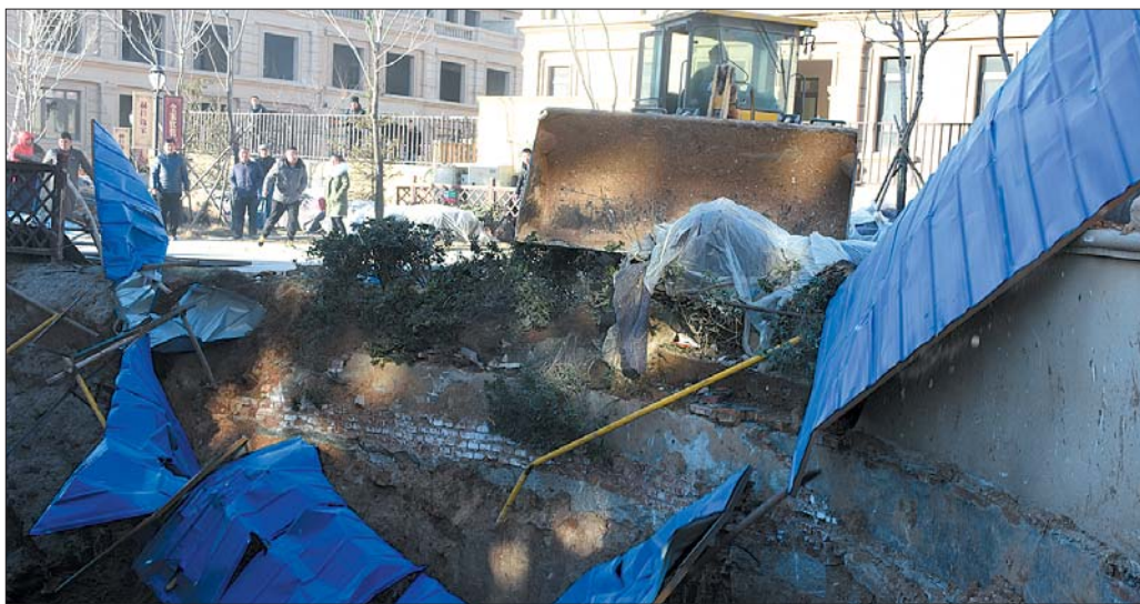
B2地块10户业主同时开挖地下室,执法人员推倒围墙用渣土回填。本报通讯员 刘荣凯 摄
