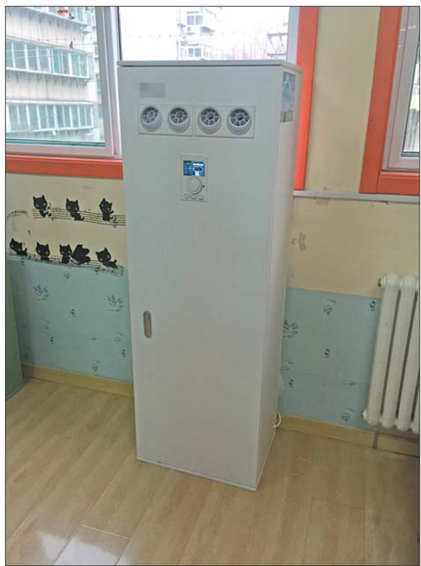
市中区某幼儿园的一间教室里安装的空气净化系统。
