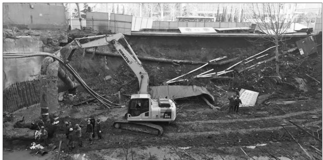
在塌陷现场,热力工作人员正在抢修管线。
