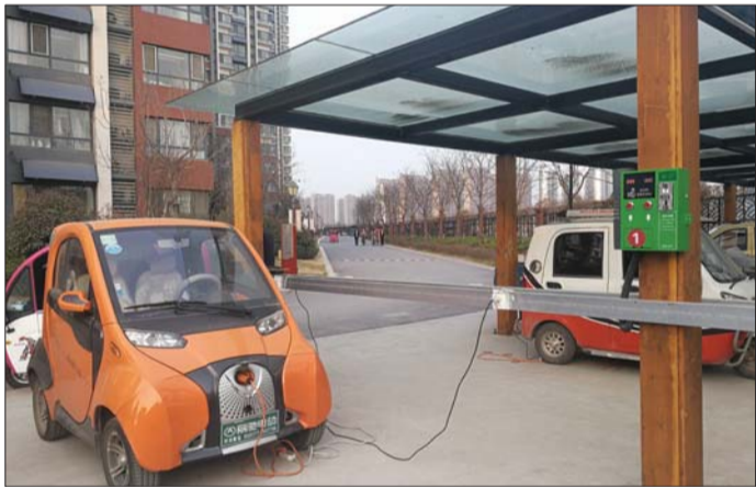
电动轿车充电桩方便业主给车子充电。
