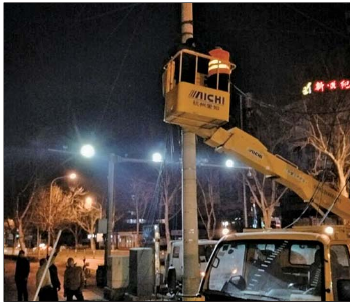
山大路解放路以北的线缆2月27日晚开始落地。历下区市政局供图
