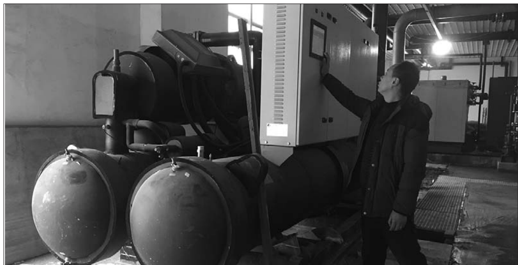
东郊热力公司已经开始尝试使用新能源供热(资料图)。
